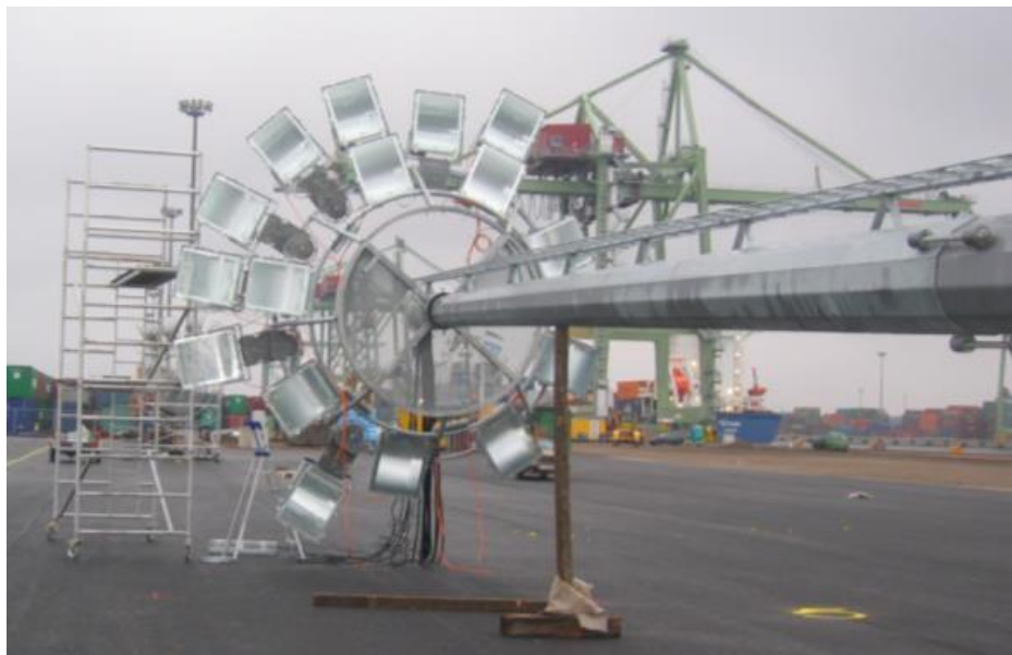
Kuva 4. Orsiston sähkö ja valaisinasennus
